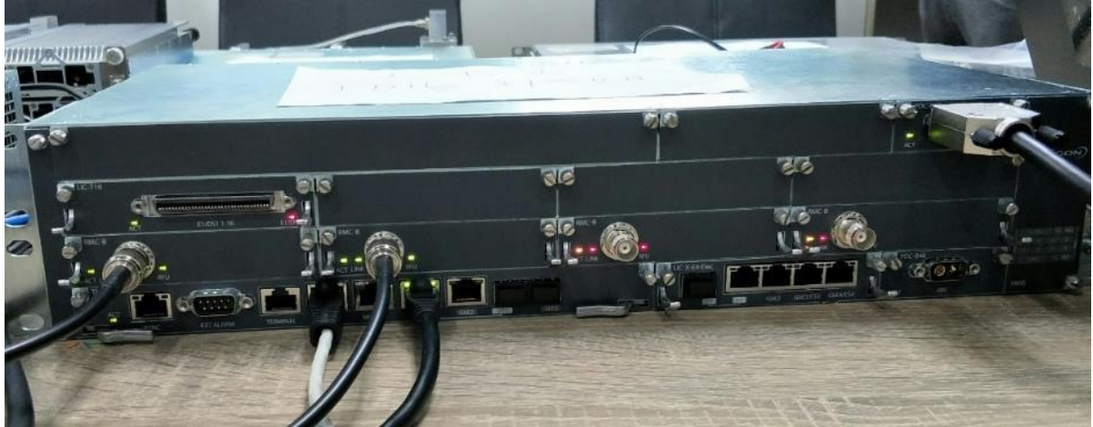
圖 6-7 故障排除後，設備燈號皆為綠燈
