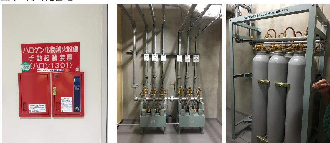
圖 13. 北海道大學植物園標本館氣態滅火系統手動開關（左），分到各室的管道（中），和集中的氣瓶（右）。
