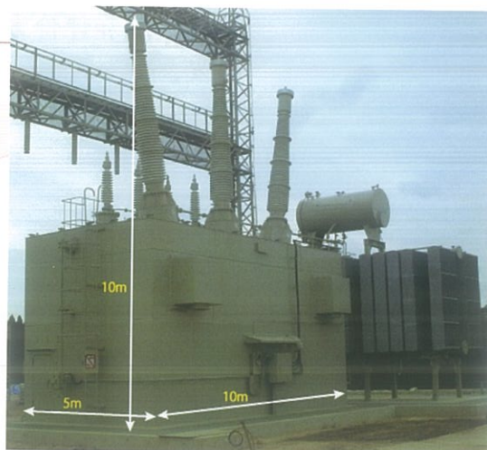
▲车顶三角形接线变压器的外观
