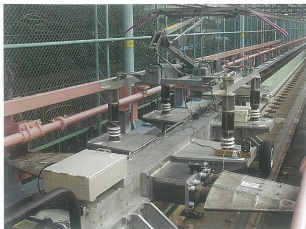
▲集电试验装置
