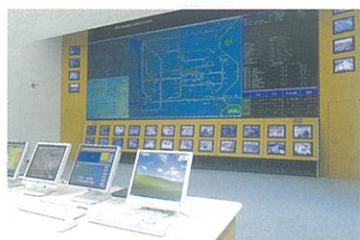
交通管制センター
