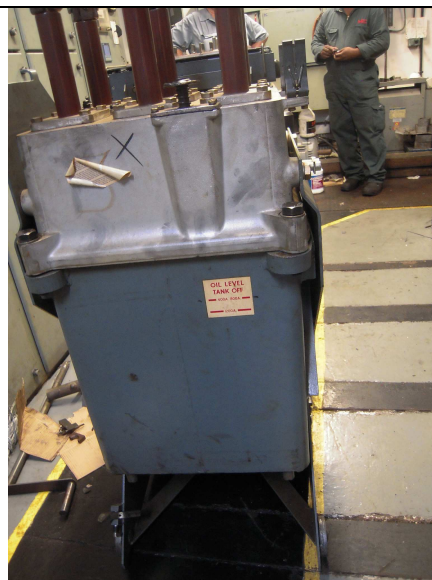
13.8KV OCB 斷路器
