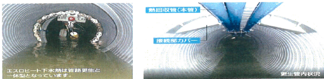
圖 8 下水道餘熱利用管線實景
