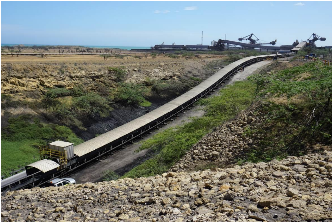
圖92 Puerto Bolivar火車卸煤站至儲煤場密閉式皮帶機
