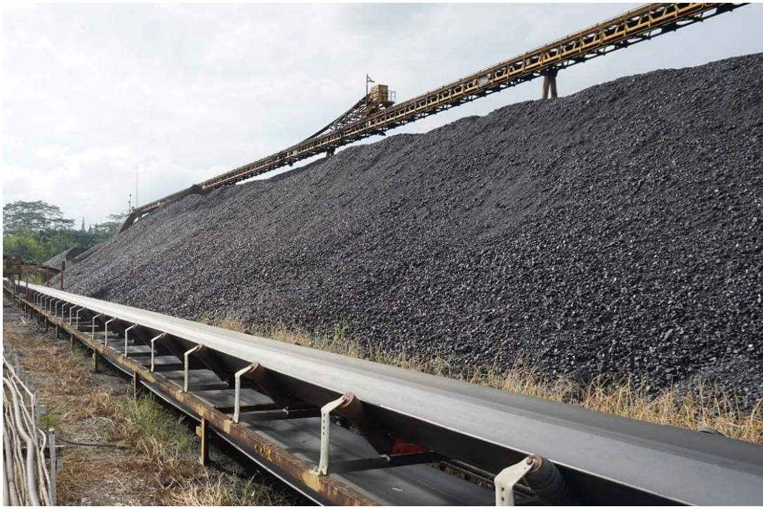
圖26 Separi Jetty產品煤輸煤皮帶機
