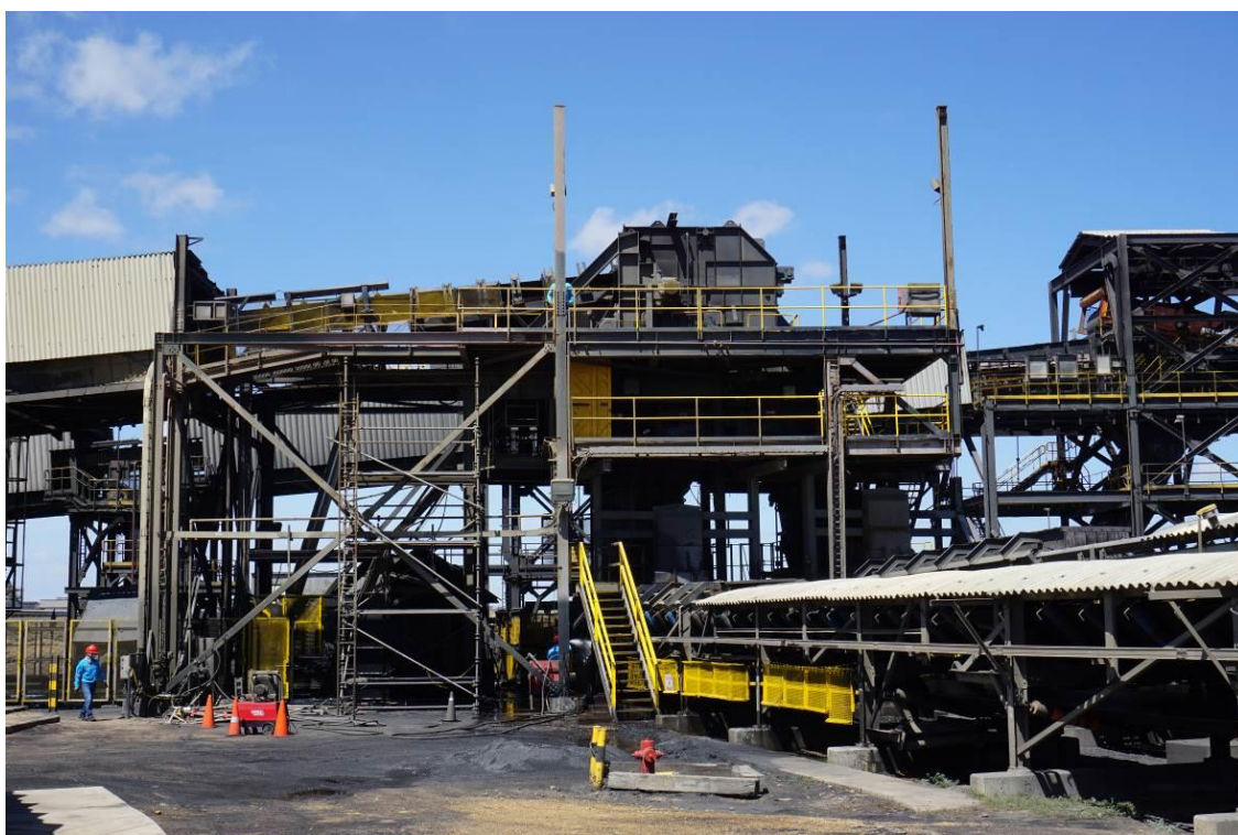
圖96 Puerto Bolivar產品煤轉送塔與磁性物質偵測器
