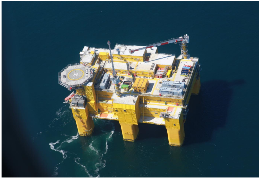
圖 9 Nordsee One 離岸風場海上變電站
