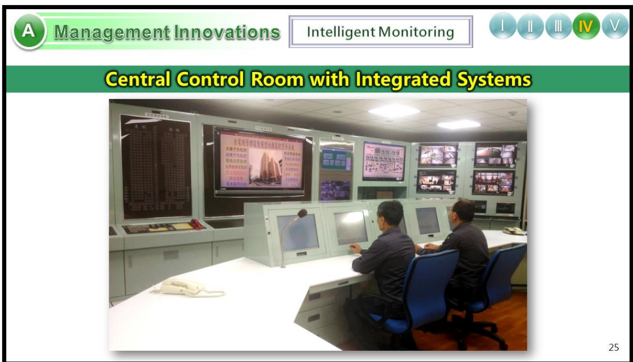
圖二十二、中央控制室
