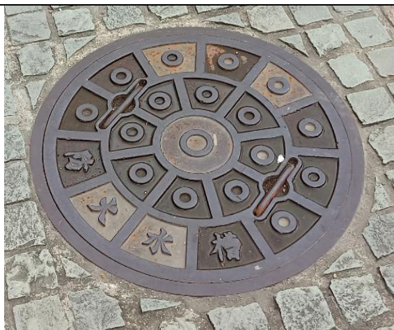
消防專用蓄水池
