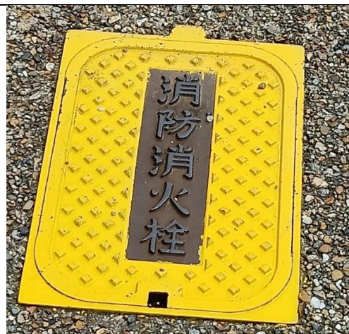
地下式消防栓
