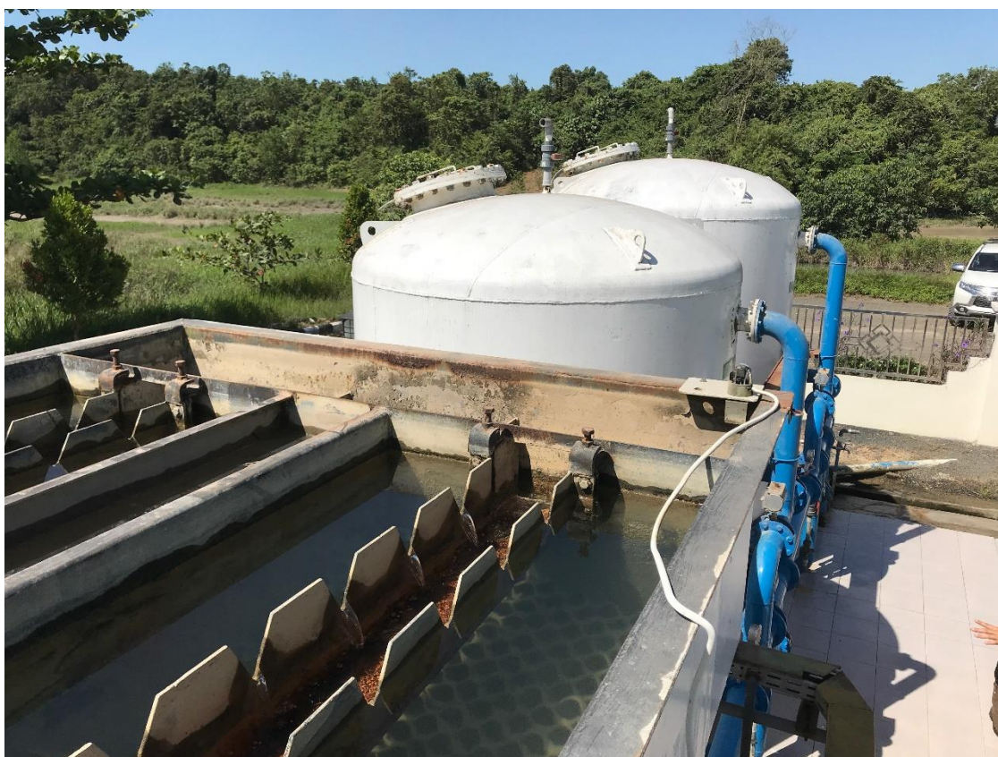
礦區再生水處理設施
