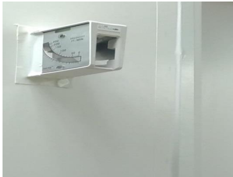
施工門外牆上設有負壓顯示器
