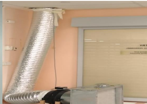
施工區域設有加強排風設備
