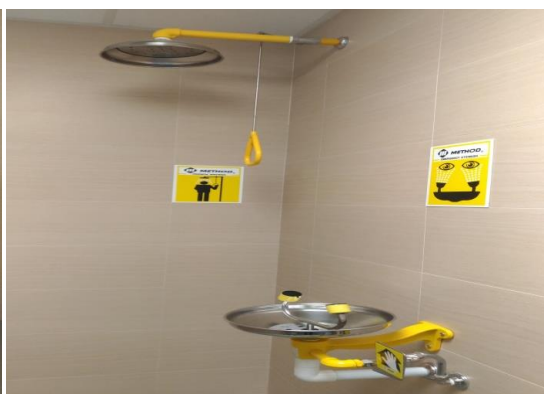
沖洗設備及沖眼設備
