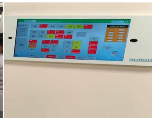
檢查室牆面上控床的面板
