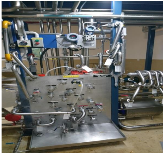
圖 9、製藥用各式大桶槽間的管線銜接、輸送統一控制站。
