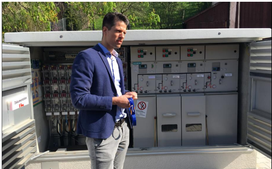
圖49 下斯特滕(Niederstetten)終端饋線二次變電站
