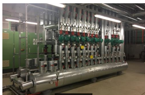
空調系統冷熱交換設備1
