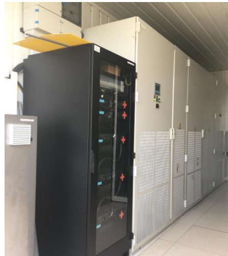
儲能系統控制室
