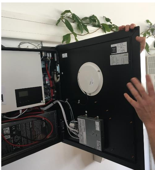
電池管理技術控制盤
