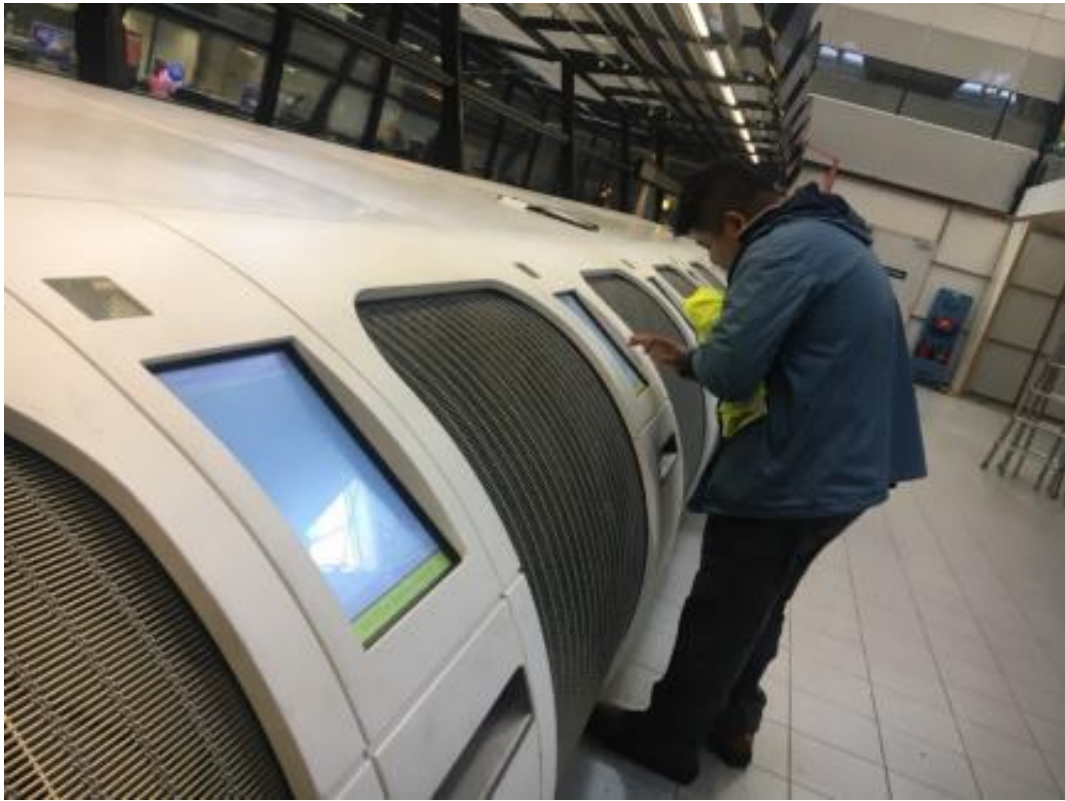
圖 41：即將於史基浦機場啟用之 SBD 設備 (2)
