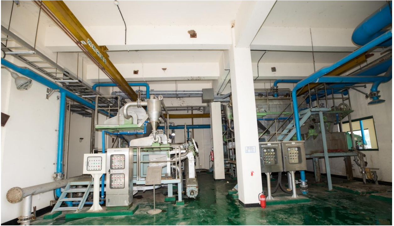
圖 38 濟州家畜糞便處理廠-場內處理設施
