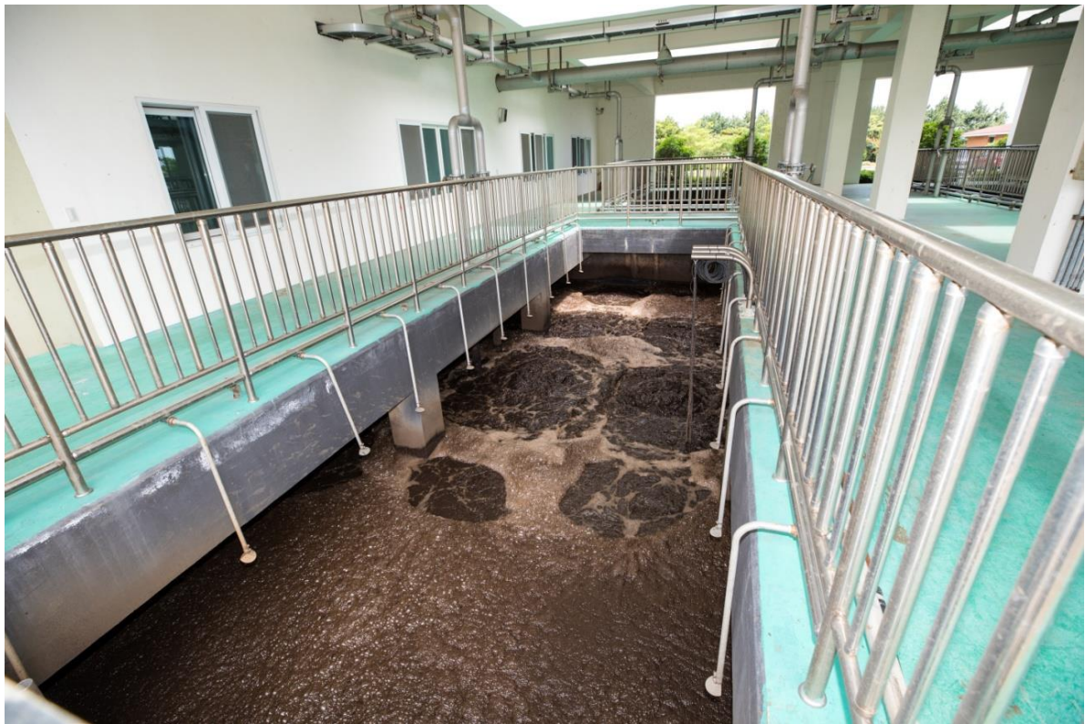
圖 39 濟州家畜糞便處理廠-場內處理設施
