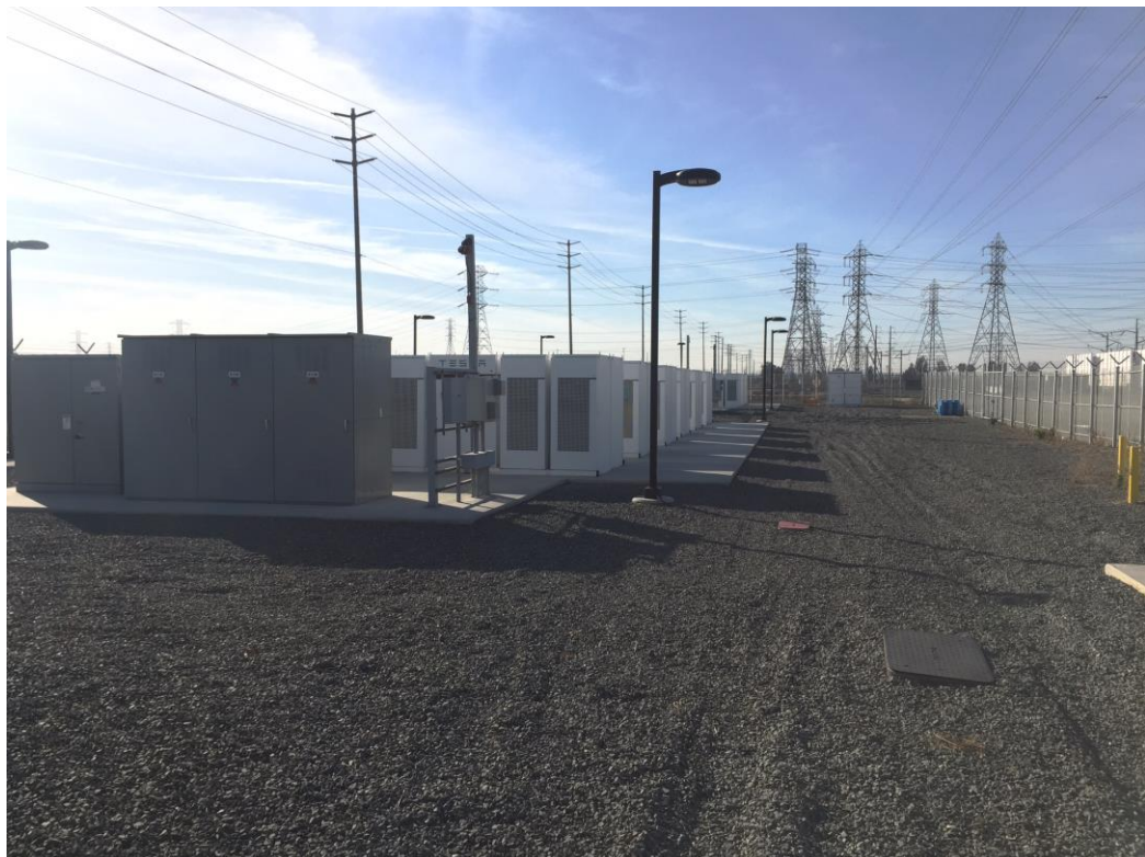
圖 18 Mira Loma Peaker & Substation 儲能系統設置情形二
