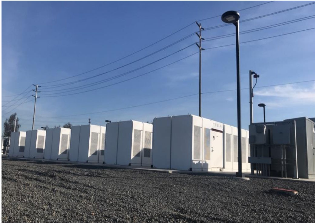
圖 17 Mira Loma Peaker & Substation 儲能系統設置情形一
