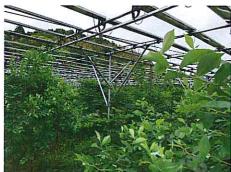
いすみ自然エネルギー(株)のソーラーシェアリング施設
