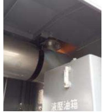
檢查引擎室 發現車頂上方排氣口滲水
