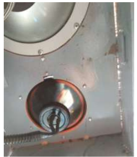
主風缸室內側頭燈罩 框架接縫滲水
