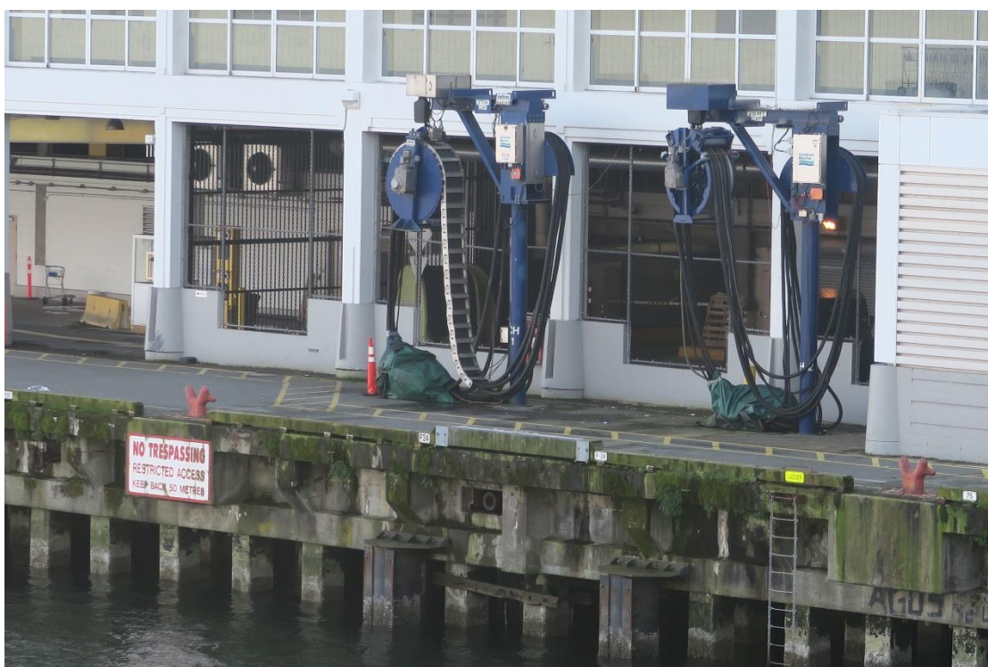
圖 74、位於西碼頭的兩座岸電設備
