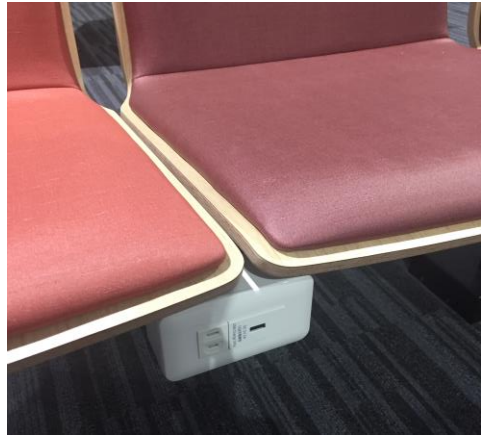
圖 4-13 二航廈候機區提供充電孔
