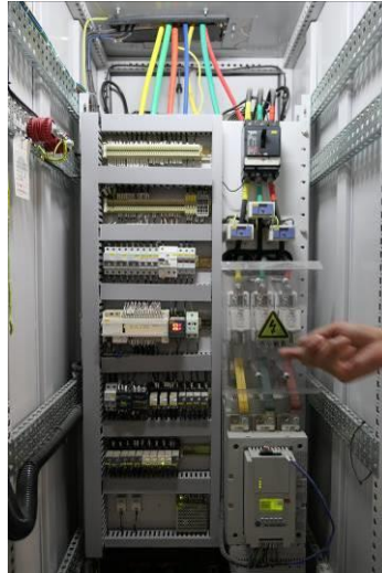
圖 3-5.3 風機控制盤內部
