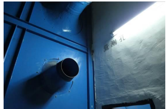
圖 3-4.24 測試中心內部設之出風口 01
