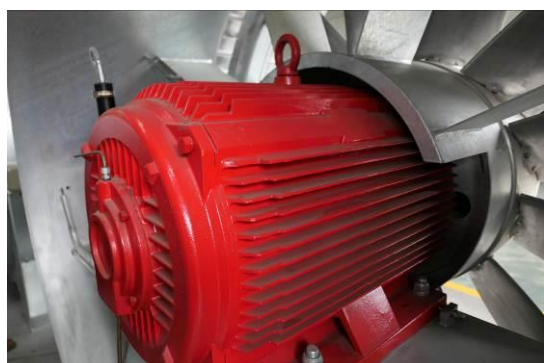
圖 3-4.17 風機馬達與潤滑油注入線路
