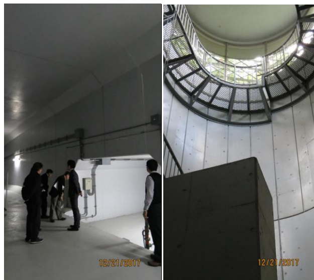
空調外氣進口與隧道
