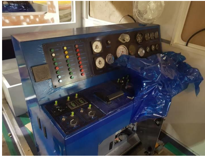
圖2.3.24 駕駛室操作台-1
