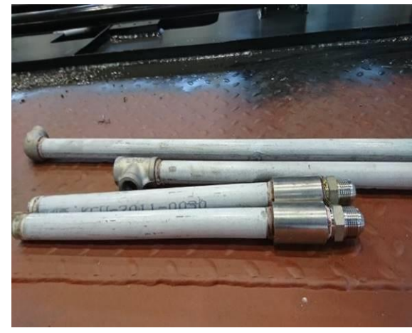
現場檢視管路連接套筒為不銹鋼材質
