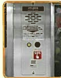
（車内非常通報装置） (Emergency alarm on board)
