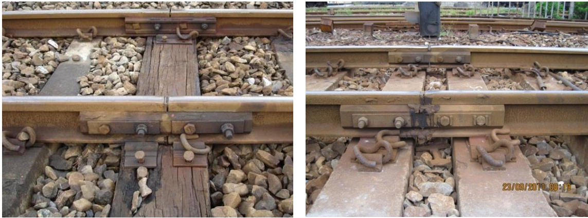
圖 57 臺鐵局絕緣接頭
