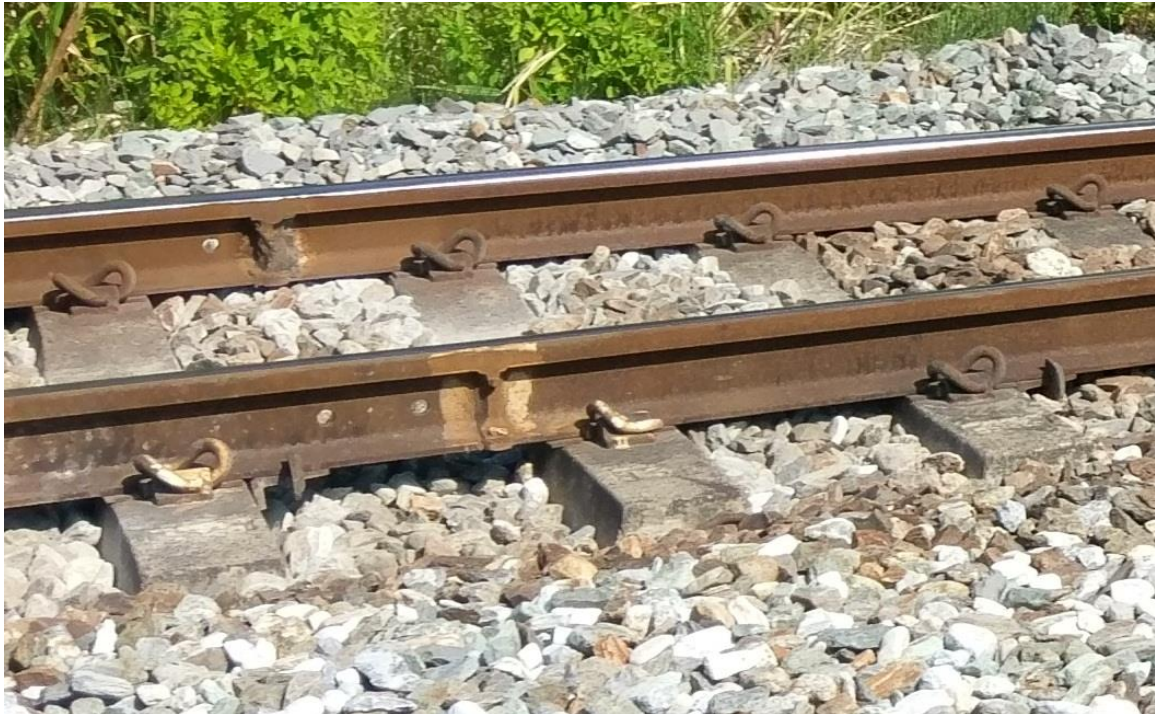
圖 76 臺鐵局防爬器設置實況照片
