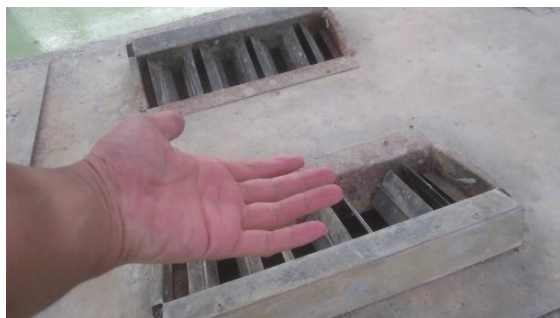
圖 51.室內冷氣通風口
