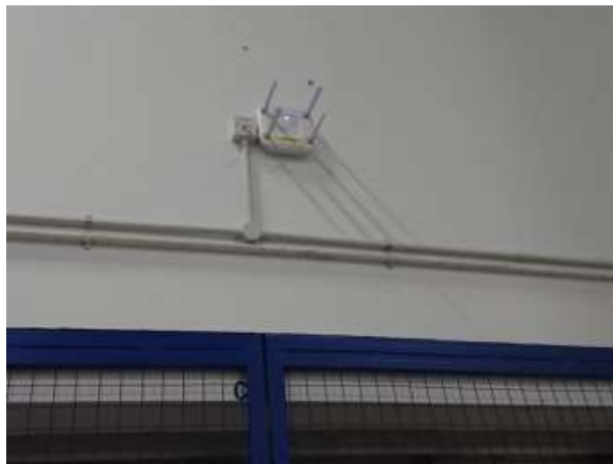
圖 40、新加坡郵政-無線網路基地臺(AP)以明管連接
