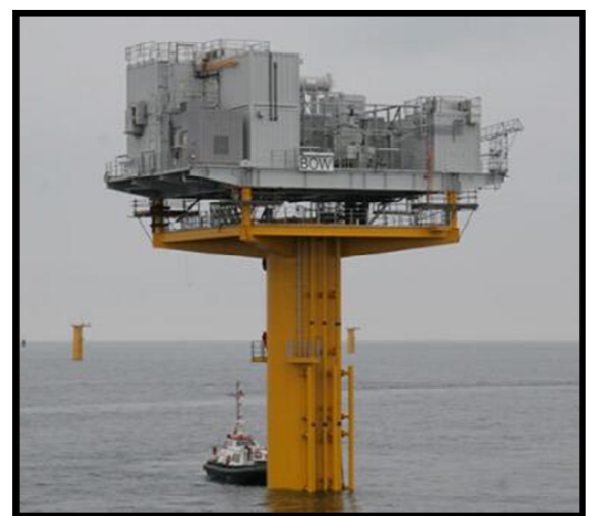
圖 3.4 第一代海上變電站
