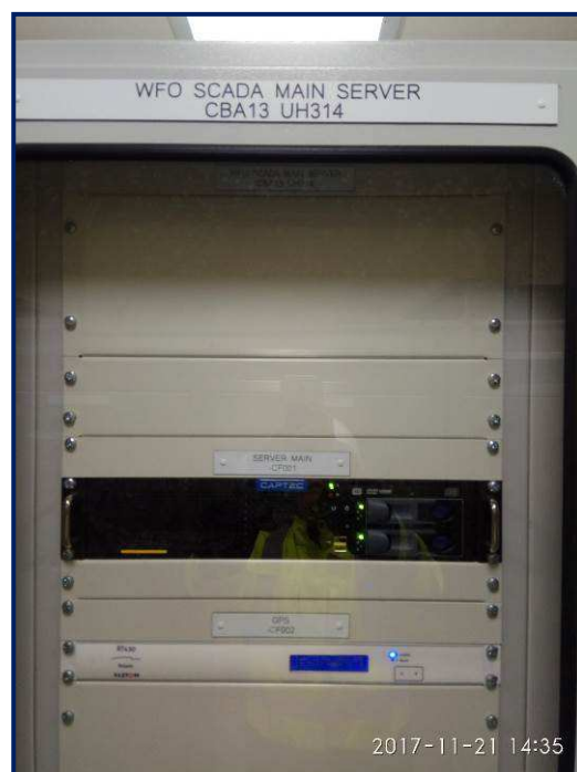
圖 3.25 Galloper WFO SCADA 監控盤
