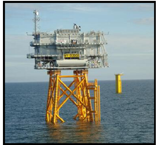
圖 3.5 第二代海上變電站
