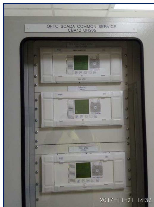
圖 3.23 Galloper OFTO SCADA 監控盤
