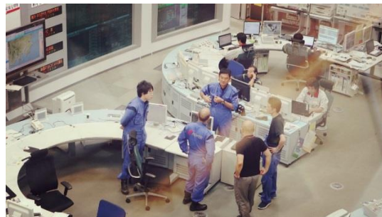
(d)發電廠控制中心
