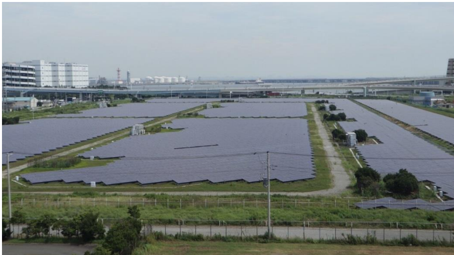
圖16 川崎風力園區浮島太陽能發電廠
