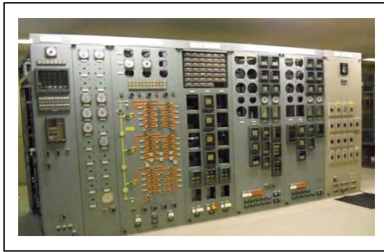
圖 3-75 變電所實習訓練場地
