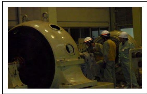
圖 3-72 水力發電實習設備
