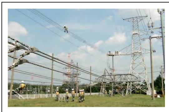
圖 3-73 輸電室外訓練場地
