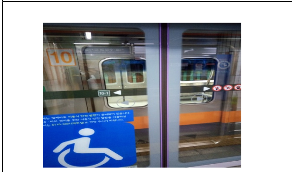
圖 2.16 捷運車站月台門 1
