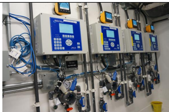
圖 24 游泳池機房設備
