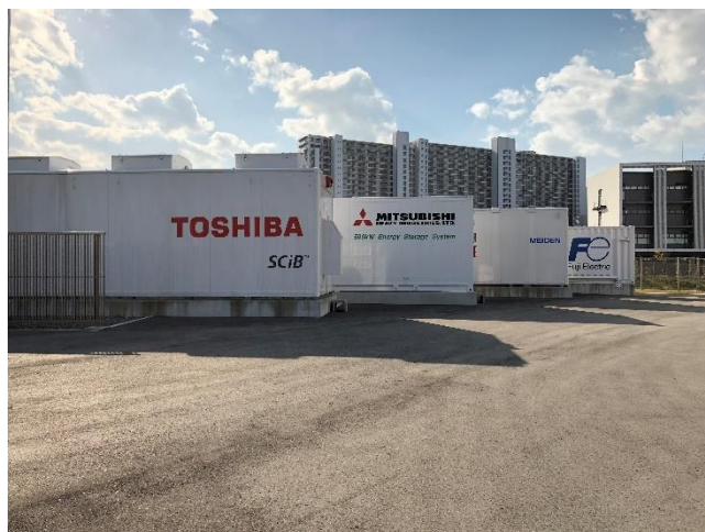
圖 3 電源供應之鋰電池儲能系統
