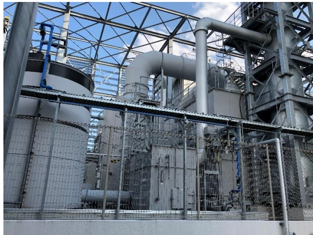
圖 2 多目的大型實驗室排煙處理設備
