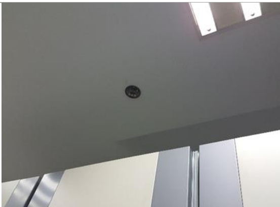
南京圖書館書庫消防設備採用氣體式滅火設備
