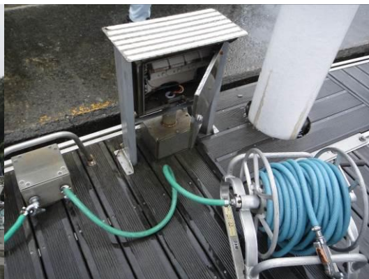
岸置水電設施
