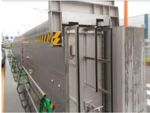
防潮堤自動防水閘門
