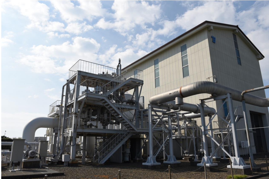
圖 38 山川地熱發電廠的汽機廠房以及主蒸氣管線
