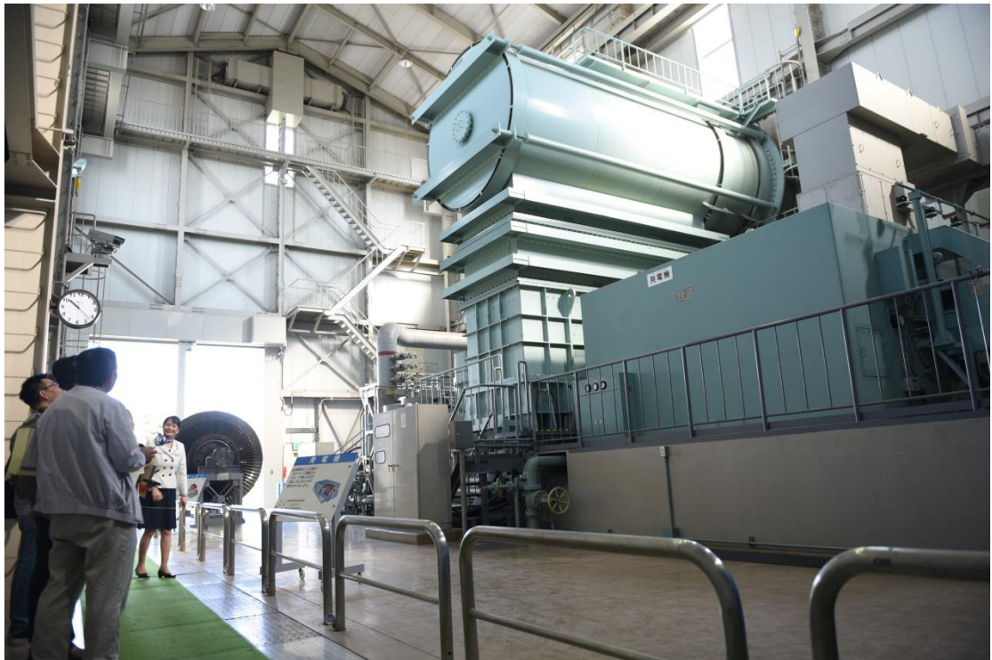
圖 42 山川地熱電廠的汽機廠房內設置有說明牌供參訪人員了解發電設備結構
