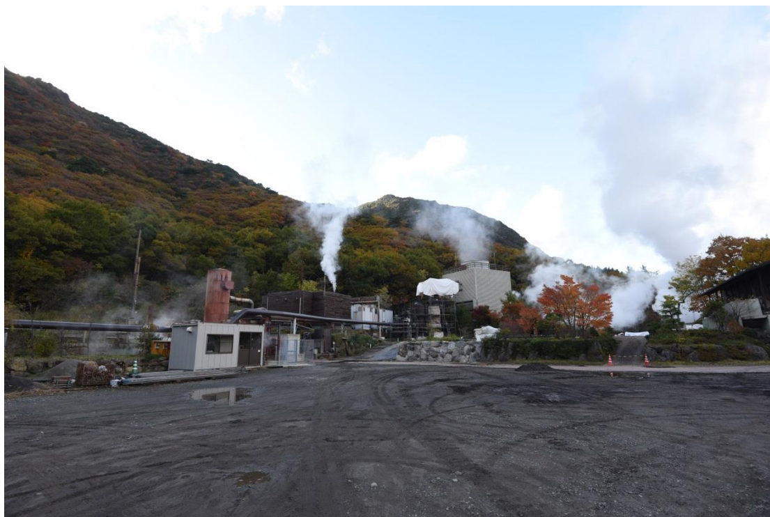
圖 24 九重地熱發電廠
