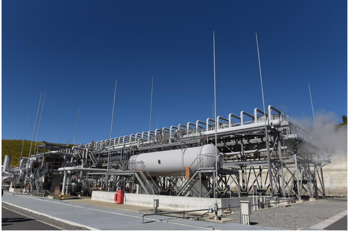
圖 29 工作流體儲槽(前)以及大型的氣冷式冷卻塔(後)
