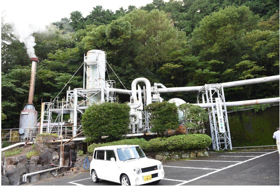
圖 4 杉乃井地熱發電廠的溫泉井及氣水分離器
