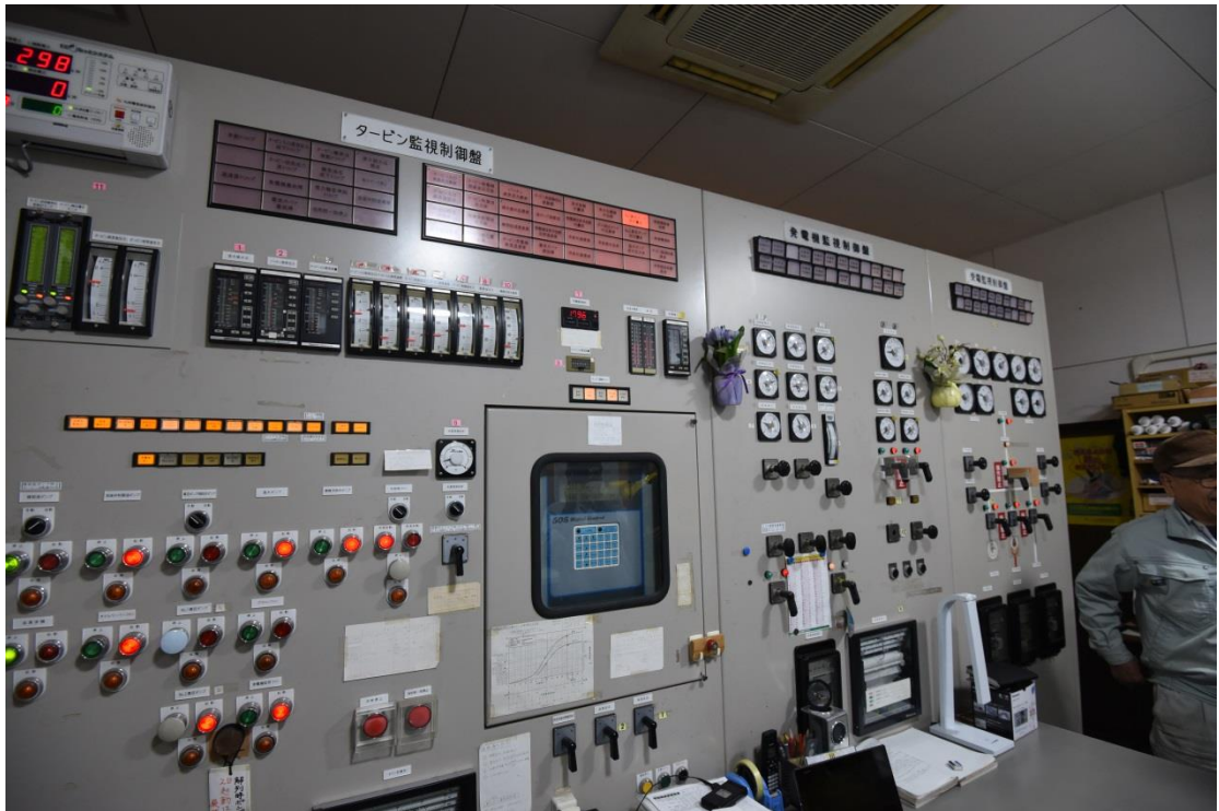
圖 26 九重地熱發電廠控制盤及各項儀表
