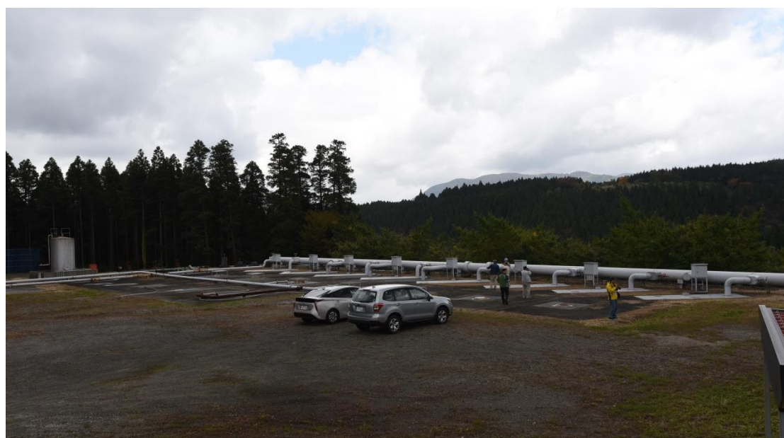
圖 15 滝上地熱發電廠地 2 號回注井基地，共有 10 口回注井
