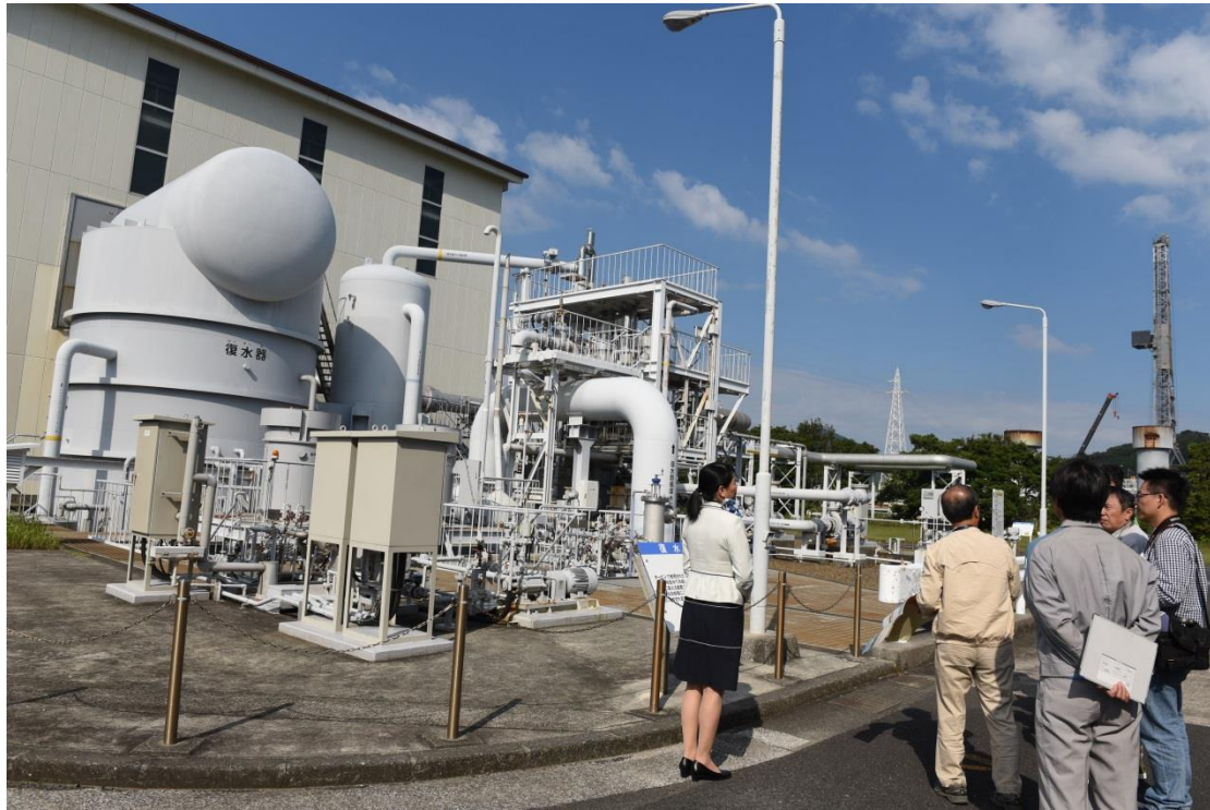
圖 39 山川地熱發電廠的冷凝器，右方背景可見新生產井鑽鑿的井架
