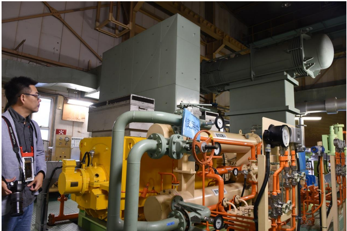
圖 5 杉乃井地熱發電廠的蒸氣渦輪機
