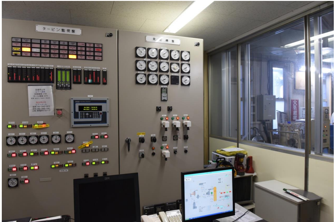
圖 6 杉乃井地熱發電廠內的控制螢幕
