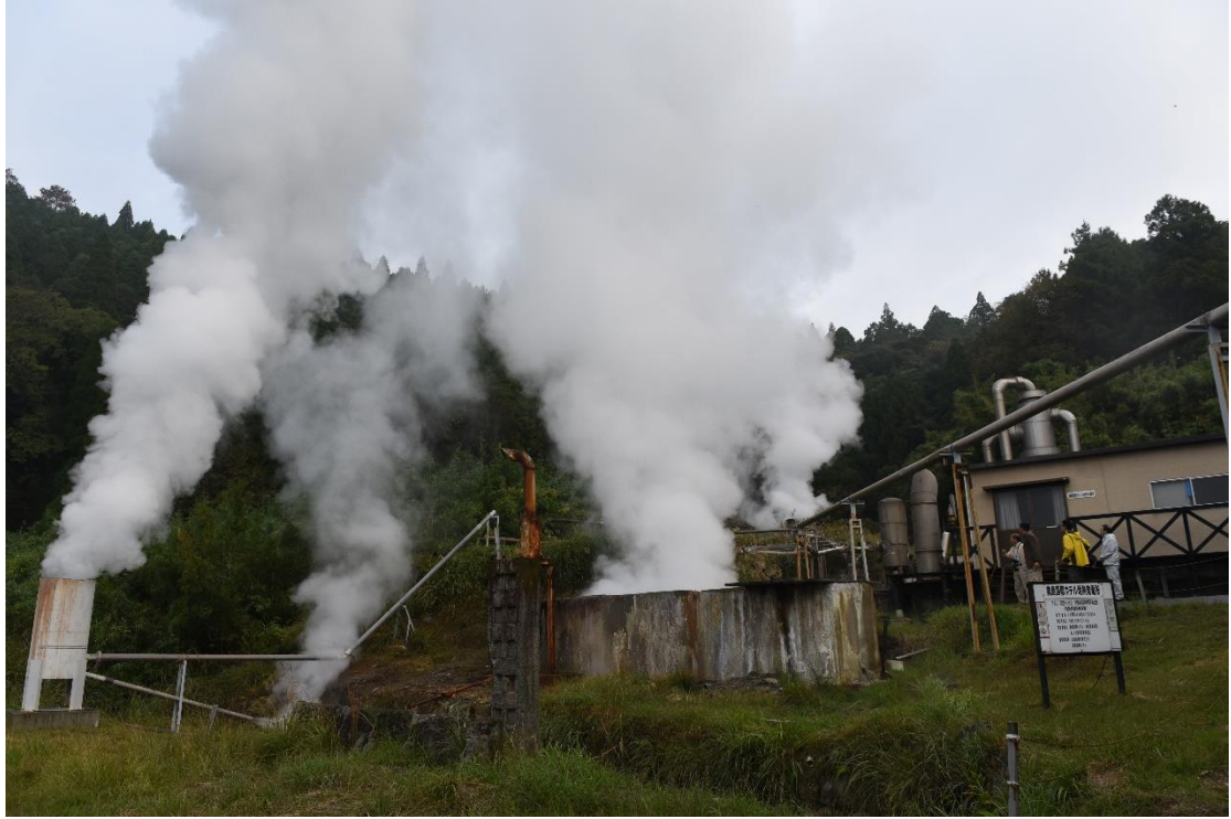
圖 50 霧島國際大飯店地熱發電廠
