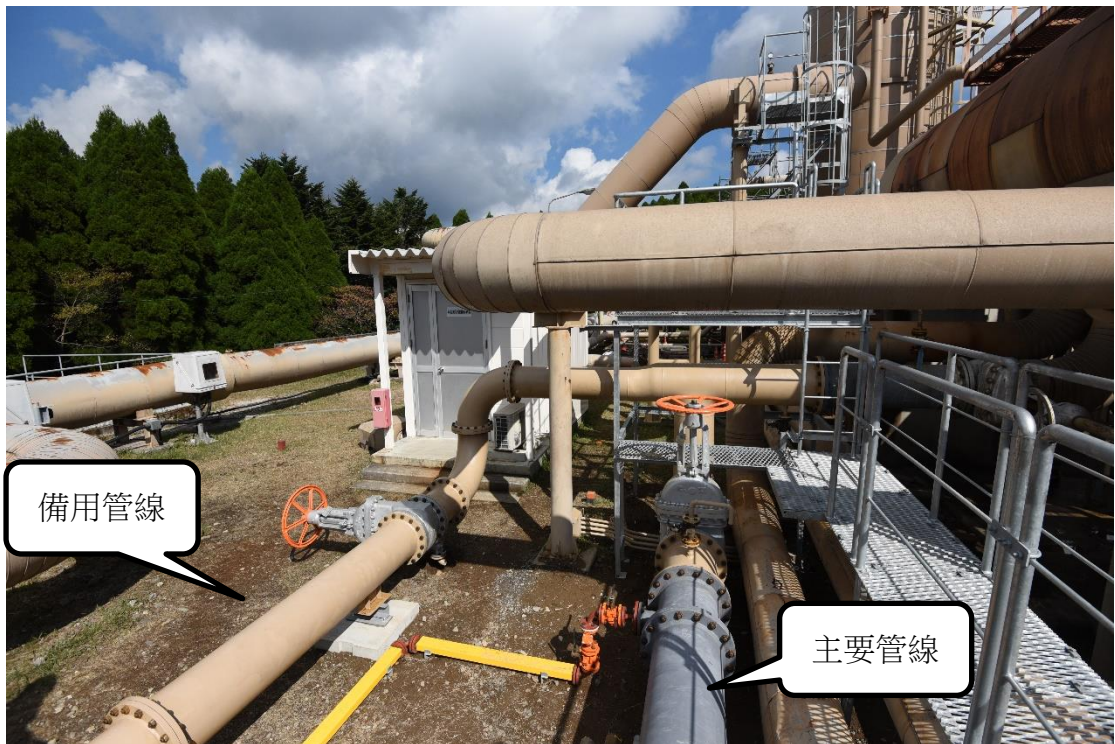
圖 56 大霧地熱發電廠通往回注井區的尾水管線
