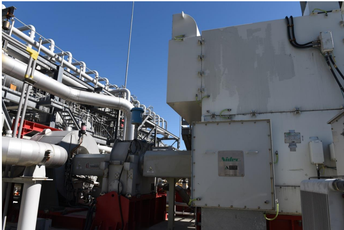
圖 28 菅原循環地熱發電廠所使用的渦輪發電機
