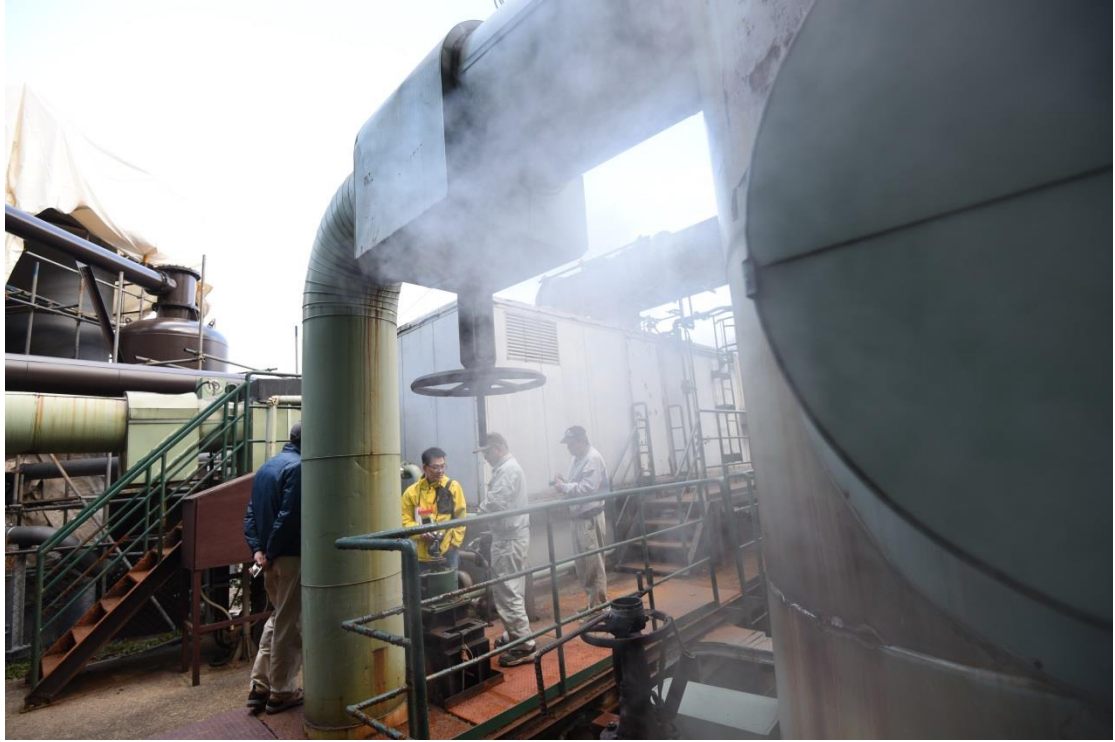
圖 25 九重地熱發電廠的管線配置十分緊湊
