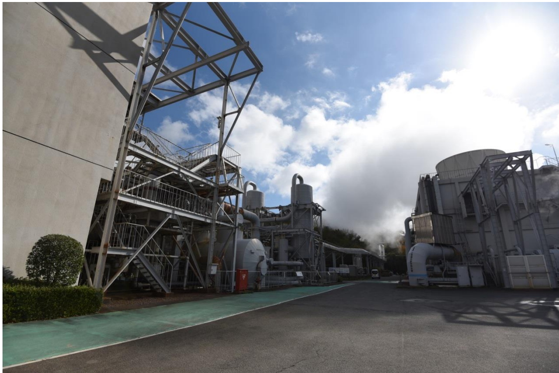
圖 16 八丁原地熱電廠的生產井管線(左)以及冷卻塔(右)，根據圖中的汽車比較可以瞭解其規模之大
