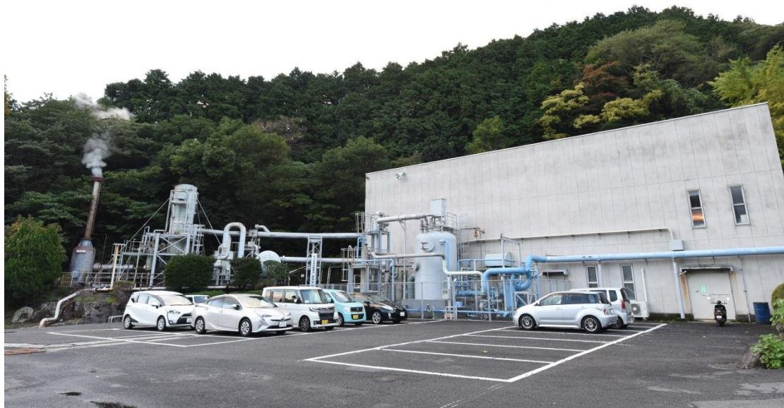
圖 3 杉乃井地熱發電廠，右方白色建築為汽機廠房以及控制室
