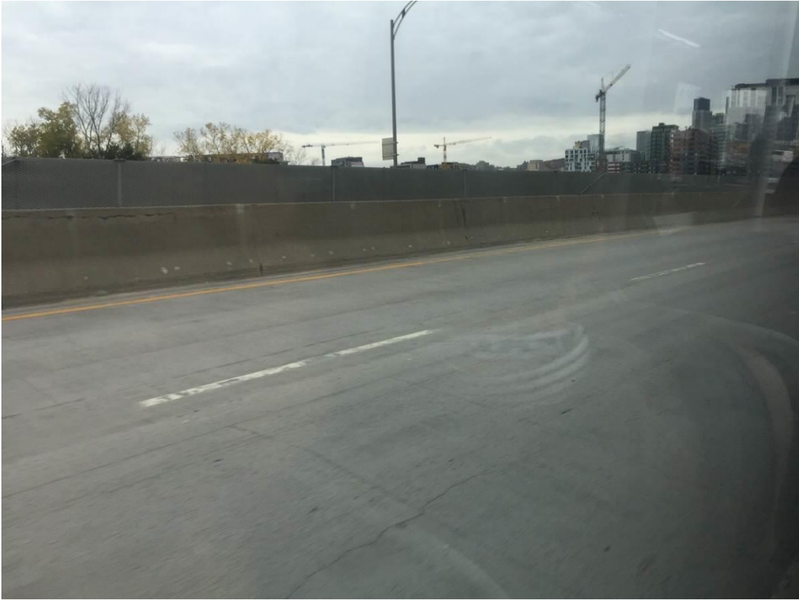
圖3-41 加高之護欄狀況
