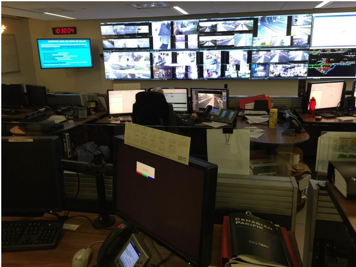
圖3-20 蒙特婁通勤鐵路控制室左側
