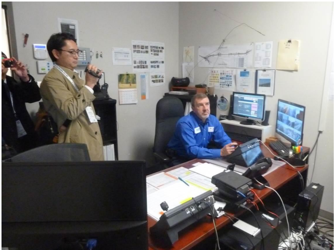
圖3-8 A25公路之交通監控中心-2
