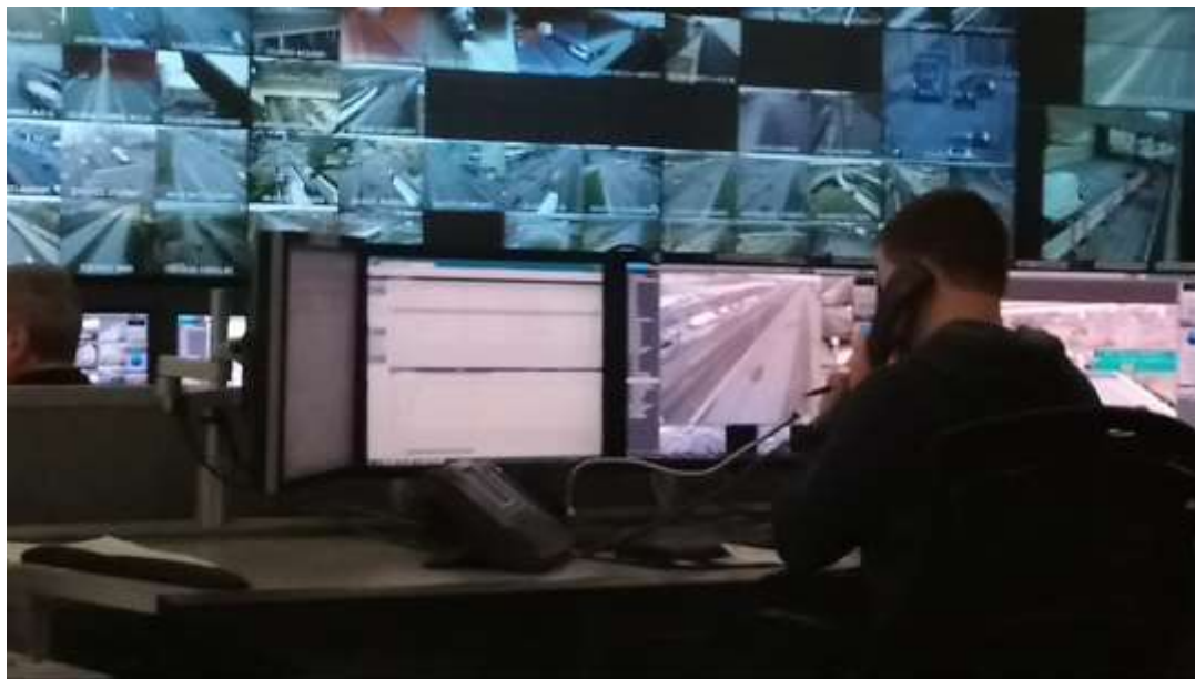
圖 30. 魁北克省蒙特婁交通管理中心 CCTV 監控中心(四)
