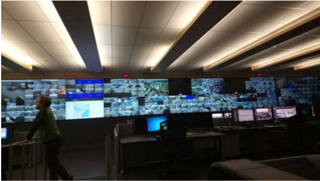
圖 27. 魁北克省蒙特婁交通管理中心 CCTV 監控中心(一)
