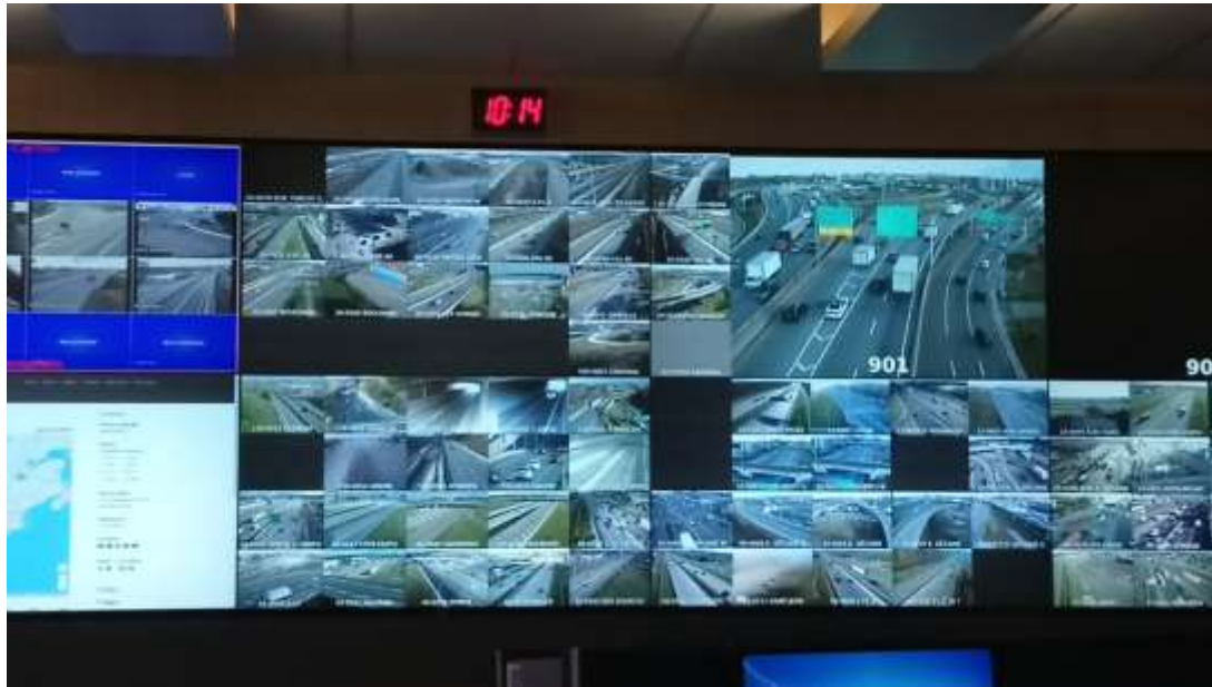
圖 29. 魁北克省蒙特婁交通管理中心 CCTV 監控中心(三)
