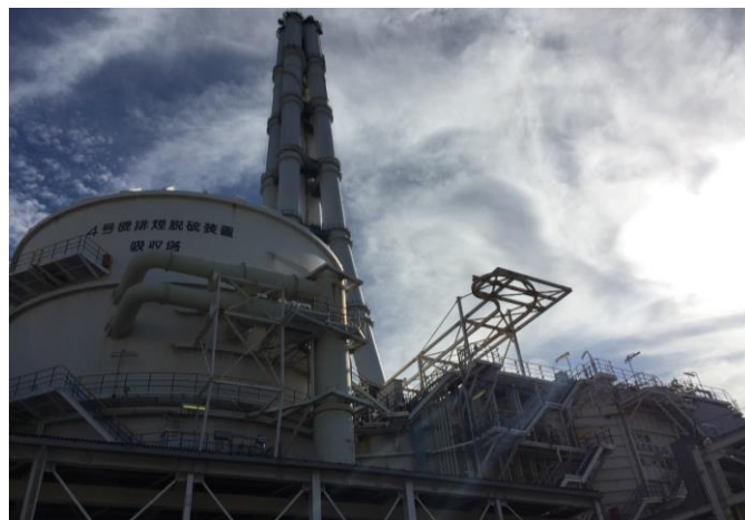
圖 17、碧南電廠第 4 號機濕式 FGD 吸收塔外觀
