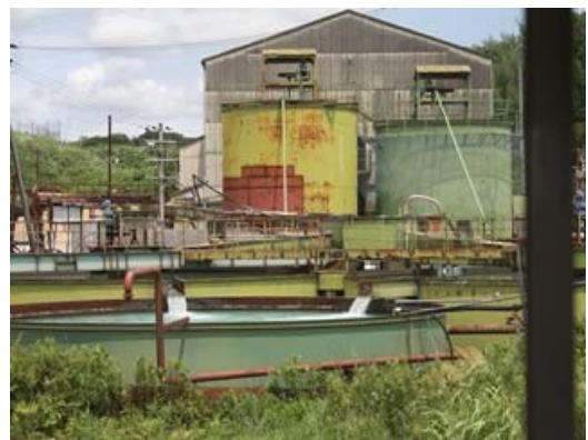
汙水處理設備
