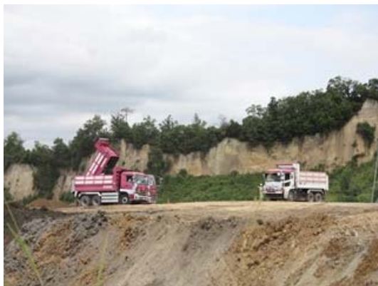
場區內作業情形 3(目視檢查營建發生土落地情形，有異狀則不予收容)
