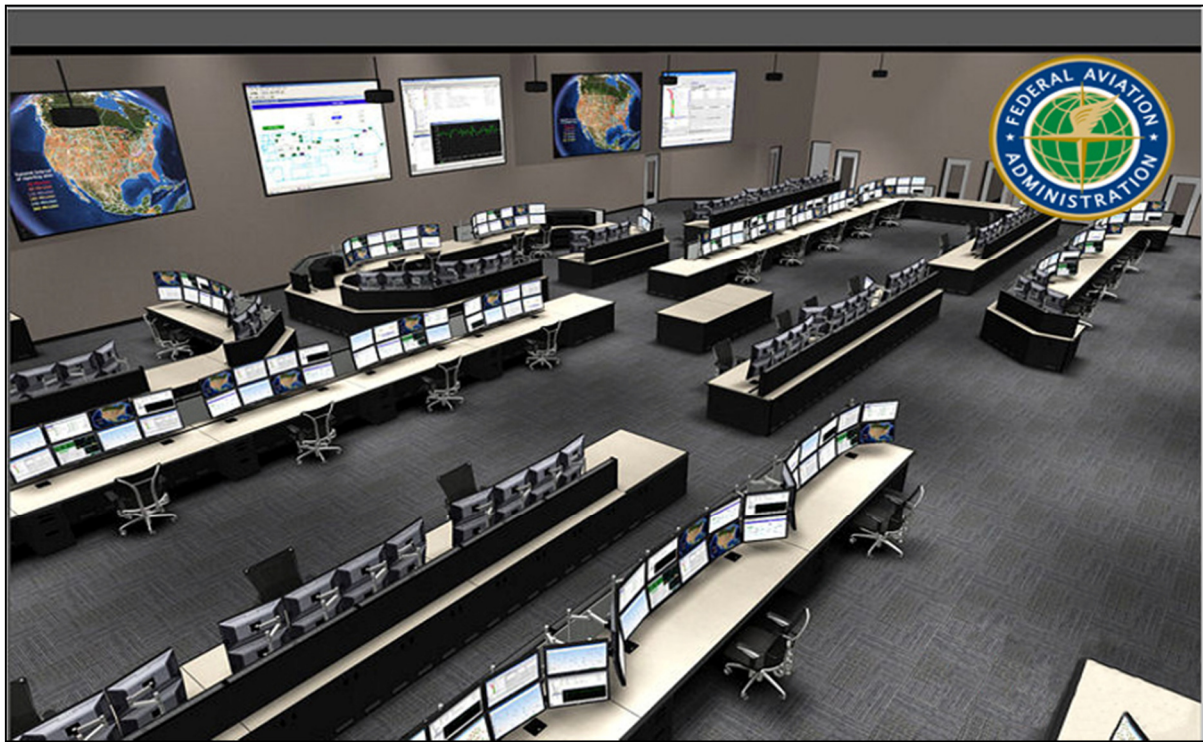
圖 陸-4 控制中心作業室
