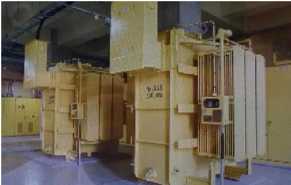
圖 25 位於 3 樓超高壓輸變電設備
