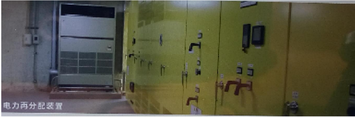
圖 24 位於 2 樓電力再分配裝置
