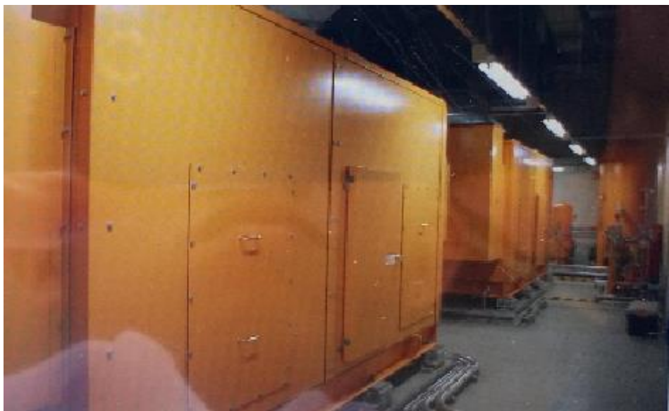
圖 26 位於 4 樓備用發電裝置
