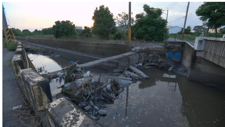
圖 3-9 暴雨造成農損及圳排溢堤
