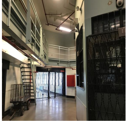
(圖 35：Millhaven 監獄分區控制中心)
