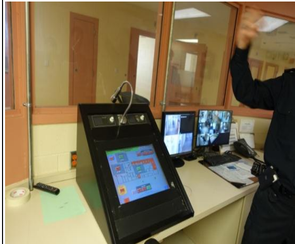
(圖 25：凡尼爾女子中心舍房門、電燈及相關設備電子操作系統)
