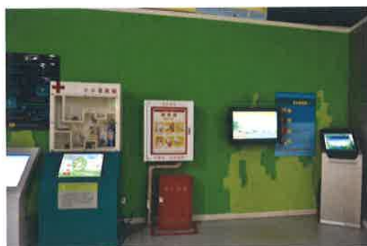
照 62 天津科學技術館消防設備
