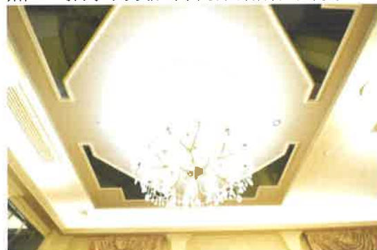
照 5 張學良故居博物館內裝空調出風口
