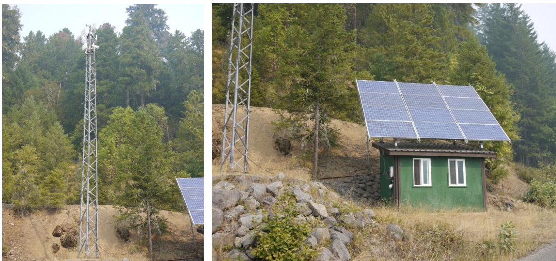
圖 5 中繼傳輸電塔之一，主要利用太陽能板充電。
