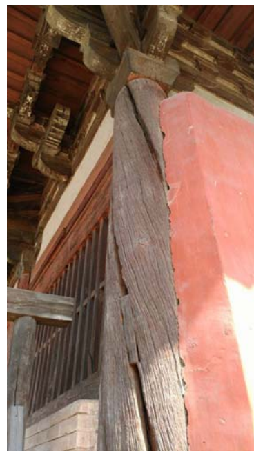
大殿龍邊轉角柱發生螺旋式裂紋，開裂程度頗大，管理單位正規劃修復工作。
