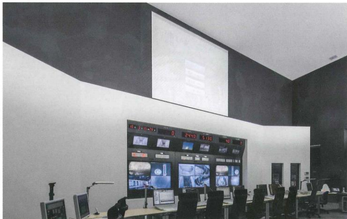
図 2.1.8 自動化設備/中控室
