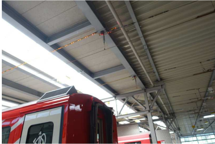
通電的電線顯示紅光，警示作業人員
